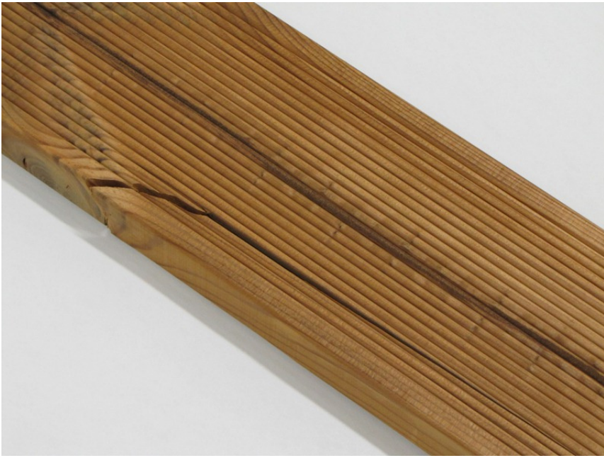
Läpimenevät halkeamat on sallittuja
