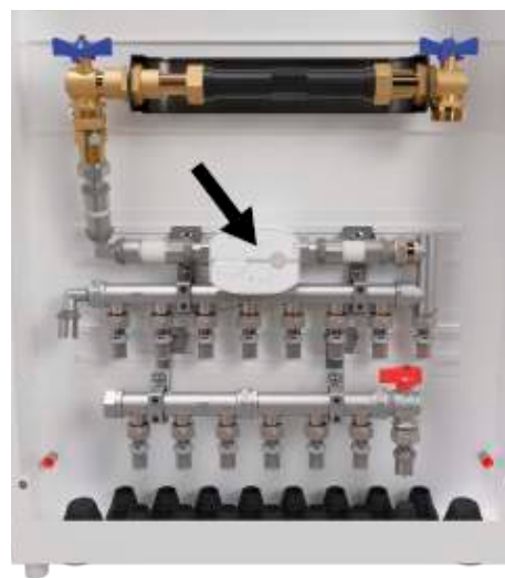
Vedenvälvontayksikkö asennettuna kaappiin.
